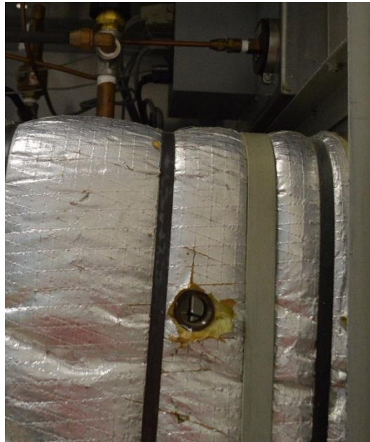
Figura 14. Orificio dentro del autoclave
