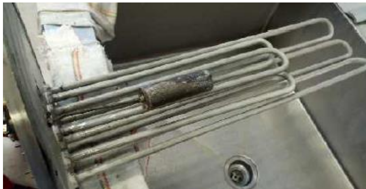
Figura 2. Fotografía del banco calefactor de la caldera.
