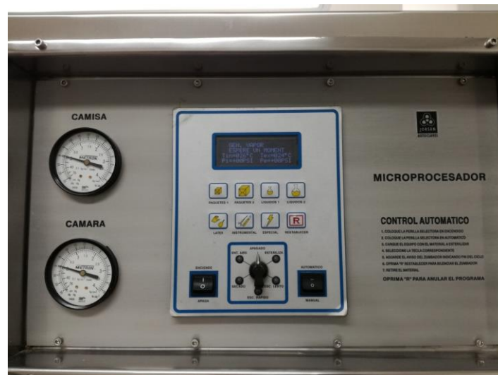
Figura 4. Fotografía del panel de control
