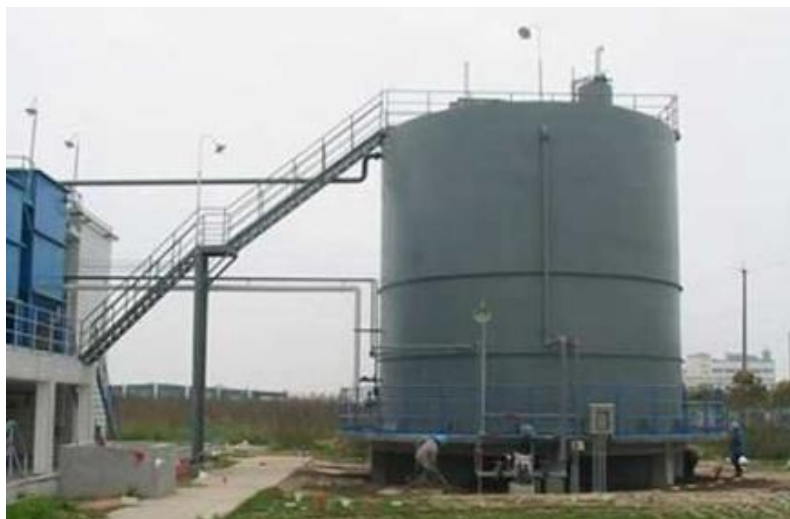
Figura 22. Reactor Anaerobio de Flujo Ascendente. Fuente: ETW International, 2020.
