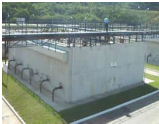
Figura 26. Reactor anaerobio con deflectores.
