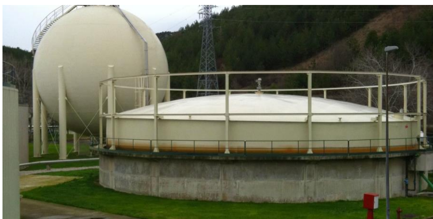
Figura 48. Equipo de digestión anaerobia de lodos.
