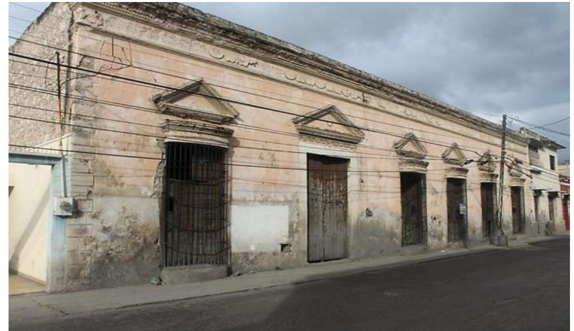
FIG.1 Estado actual de la fachada, vista de los daños
