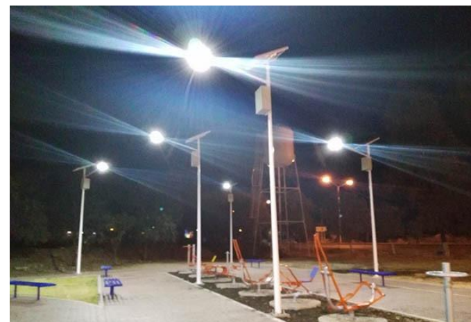
Imagen 40. Luminaria con celda solar https://gruposolinc.com/
