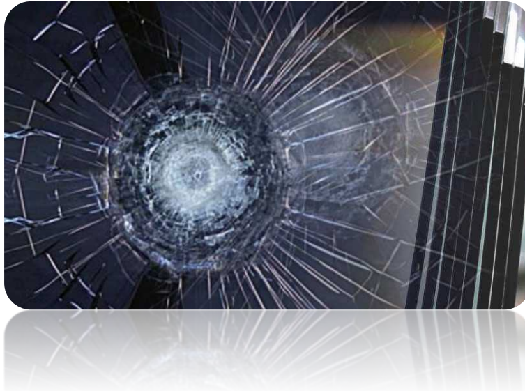
Figura 2.13. Falla de vidrio laminado
