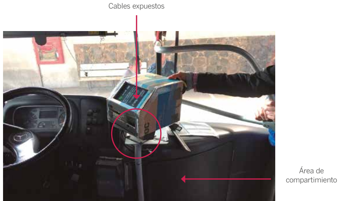
Fig. 68. Actualmente los cables están expuestos sin ninguna protección. Fuente propia.
