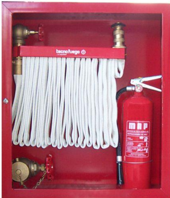
Gabinete contra incendios (Imagen) Recuperado de: https://grupoloshidroscd.ec
