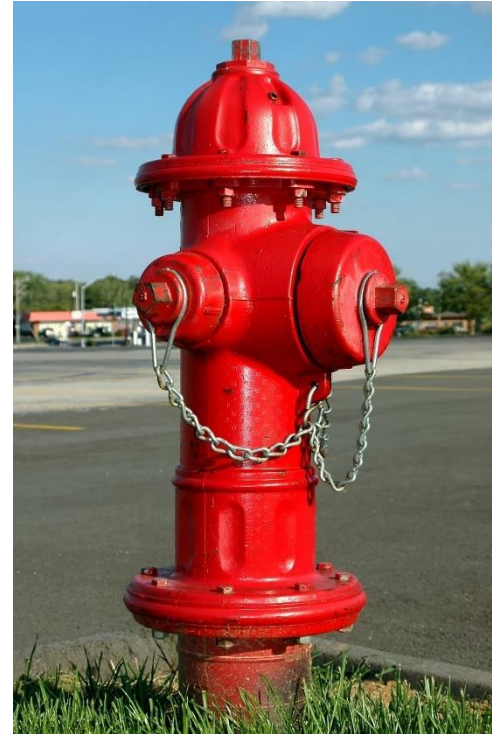
Hidrante (Fotografía) Recuperado de: https://www.extintoresenmadrid.net
