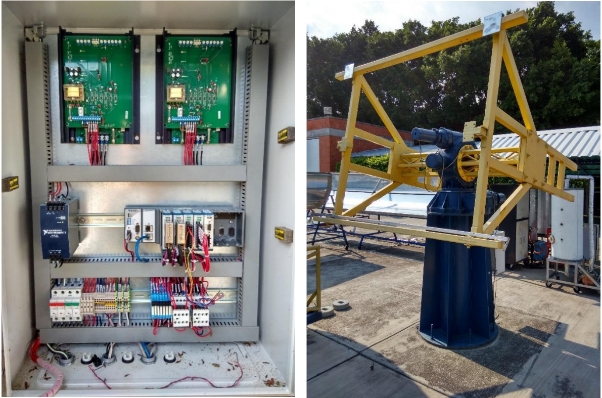
Figura 4.30. Sistema de seguimiento. Izquierda: Gabinete de control de seguimiento. Derecha: torreta de seguimiento solar de dos ejes.
