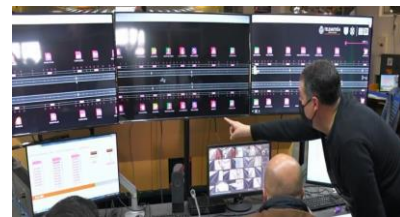
Ilustración 79. Operación por telemetría en el CCT Buen Tono.
