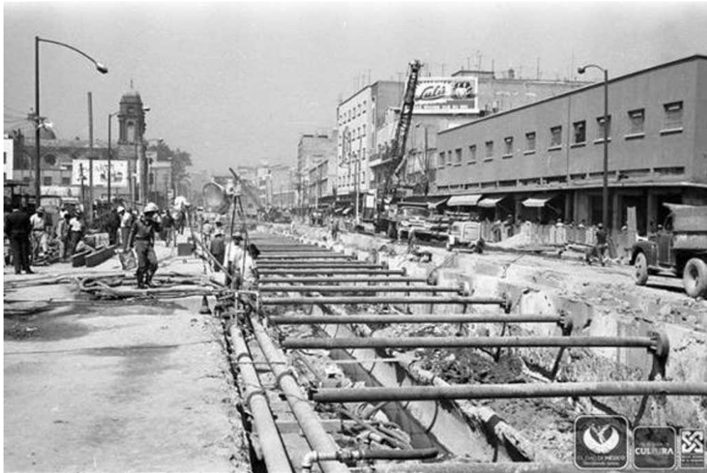
Fotografía 2. Excavaciones en la avenida San Pablo para la construcción de la línea 1, 1967. Autor: STC Metro.
