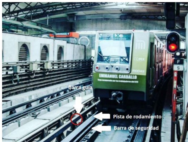
Ilustración 24. Sistema de riel electrificado, metro de la Ciudad de México. https://www.atraccion360.com/cual-es-la-barra-con-electricidad-de-las-vias-del-metro
