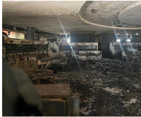
Ilustración 76. Instalaciones incendiadas en Buen Tono. Fotografía de: Milenio Noticias, 13/01/2021.
