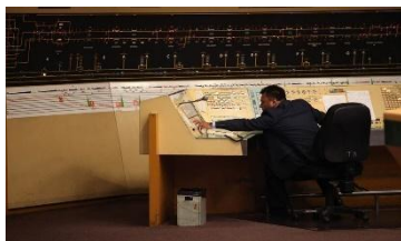
Ilustración 78. Operación manual en el CCT Buen Tono.
