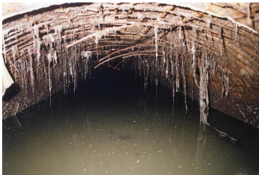
Figura 10 Corrosión en revestimiento, Túnel Emisor Central, México (García, s.f)
