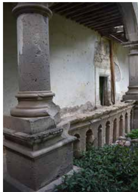
Ilustración 40. Columna ubicada en pasillo que conecta al acceso con patio central, esta estructura presenta un desplome significativo, se propone su apuntalamiento provisional para no poner en riesgo la integridad física de las personas que ingresen al inmueble.
