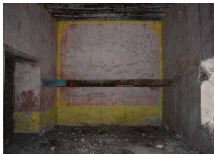
Ilustración 44. Muro con presencia de varias capas de pintura, aplicadas durante distintas temporalidades, se propone el ahondar en el análisis de las capas que contiene para determinar su acabado.
