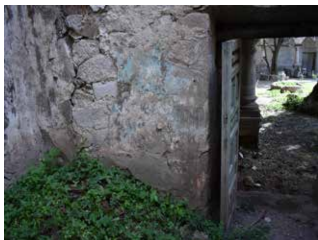
Ilustración 39. Muros con presencia de flora parásita, se propone su remoción a través de solución de cloro para alberca, bórax y agua oxigenada aplicada por aspersión.
