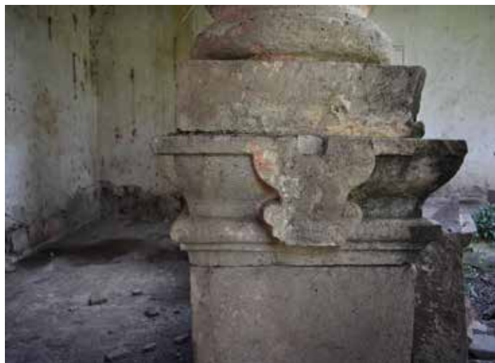
Ilustración 42. Balaustrada con presencia de elementos faltantes, se propone su reintegración mediante el previo labrado de la pieza en el material original: cantera rosa, respetando el diseño original.
