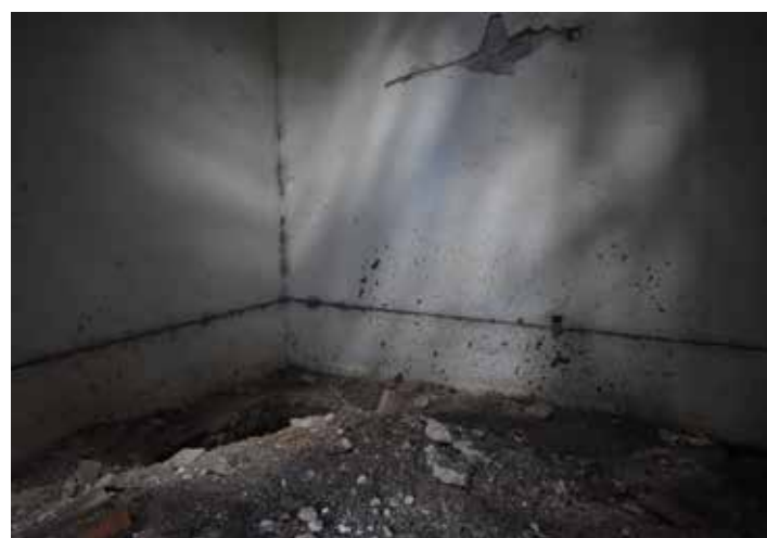
Ilustración 45. Local que presenta la remoción del firme y excavaciones, se propone rellenar la previa excavación y posteriormente integrar un acabado que se integre con la utilización de los materiales pétreos de la región.
