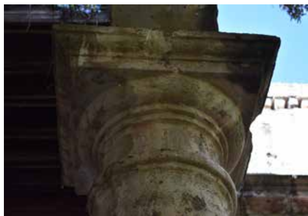
Ilustración 38. Deterioro por humedad y factores biológicos ubicada en columna ubicada en patio central, se propone una limpieza en seco y posteriormente limpieza por medio de solución de detergente neutro.
