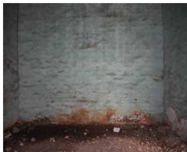
Ilustración 41. Aplanados existentes en considerable estado de deterioro, se propone su consolidación por medio de inyecciones en los casos que se considere conveniente. Fuente: Silvia Araceli Frausto Luján, 2018.
