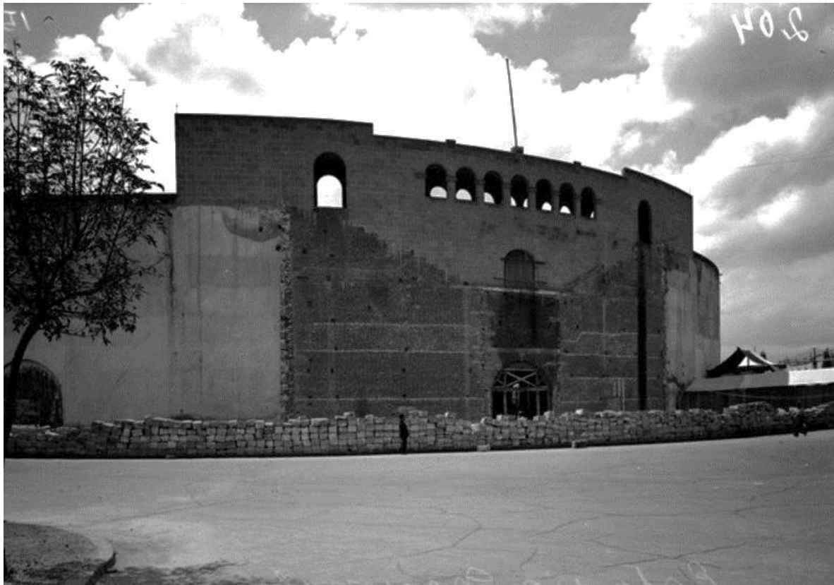
Fotografía 22. Desmantelamiento de la fachada del Estadio Nacional, ca. 1939 Fuente: Archivo Casasola – Mediateca INAH
