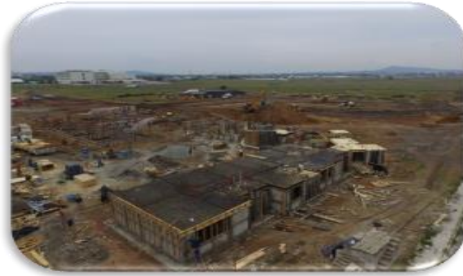
Foto 1.6 Vista aérea de estructura en P.B. de Edificio T-120200, Residencia de Obra.
