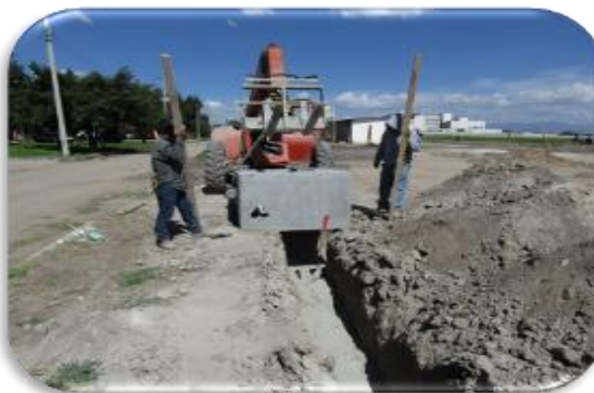
Foto 1.18 Registro eléctrico en Red de Media Tensión, Residencia de Obra.
