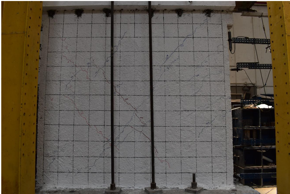
Figura 125. M-1R a \delta = 0.002 . Grieta pico: 0.6 mm, grieta residual: 0.1 mm.
