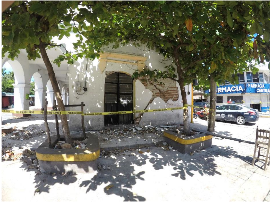
Figura 2. Estructura de mampostería dañada en el sismo de México del 07/sep/17 (créditos: H Guerrero).
