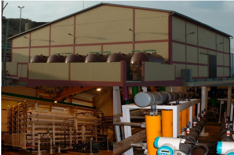
Figura 47. Planta desaladora mediante ósmosis inversa en Perú (Acciona, 2021)
