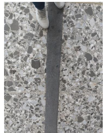
Cambio de uso de material en la ruta táctil dentro de la estación Buenavista.
