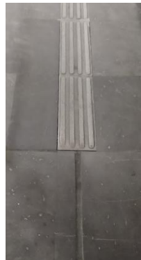
Cambio de material en ruta táctil; hundimiento sobre superficie-baldosa táctil. Hace falta una sincronización de dichos elementos en un solo trazo, además de cambios de nivel.
