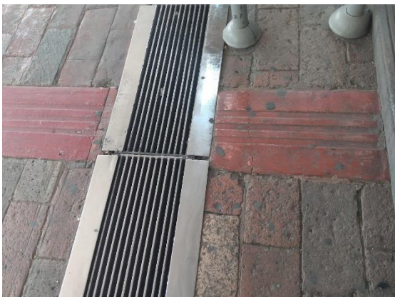
Falta de barandales y señalización de rampa.
