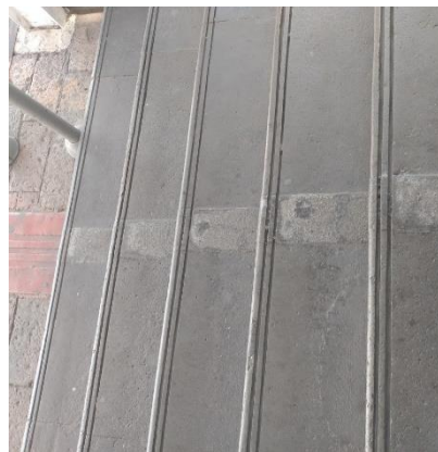
Falta de barandales y señalización de rampa.
