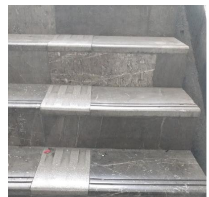
Falta de mantenimiento y condiciones de las escaleras.
