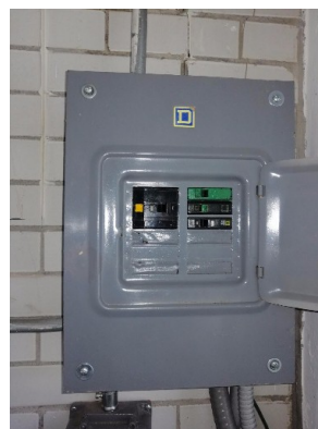
Figura 4-37: Imagen 5 Tablero A Laboratorio Microbiología de Cosmos
