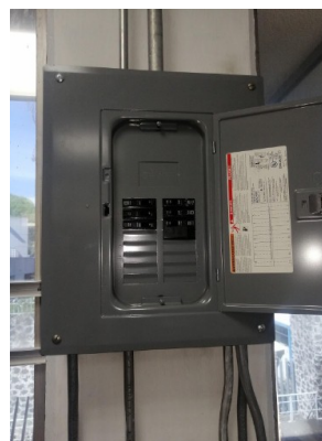
Figura 4-38: Imagen 6 Tablero B Laboratorio Microbiología de Cosmos
