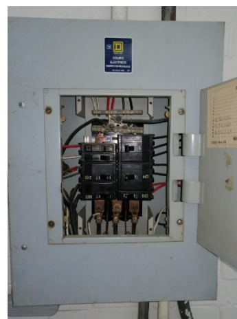
Figura 4-45: Imagen 11 Tablero C Laboratorio Biogeoquímica
