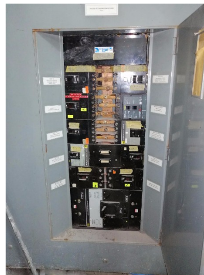
Figura 4-47: Imagen 12. Tablero de distribución derivado TD1
