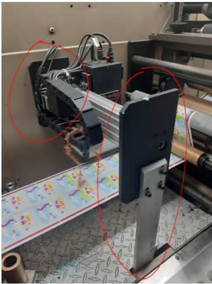
Figura 39 Sistema de inspección de video instalado. Fuente: Empresa del caso de estudio.
