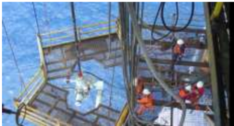
Figura 4.35 Secuencia de instalación submarina del XT
