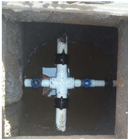
Fotografía 3.2.- Caja de Válvulas.
