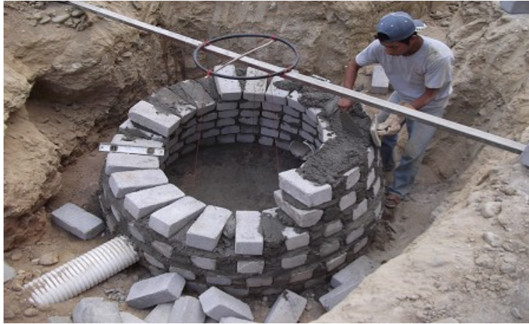
Fotografía 3.3.- Pozos de visita.
