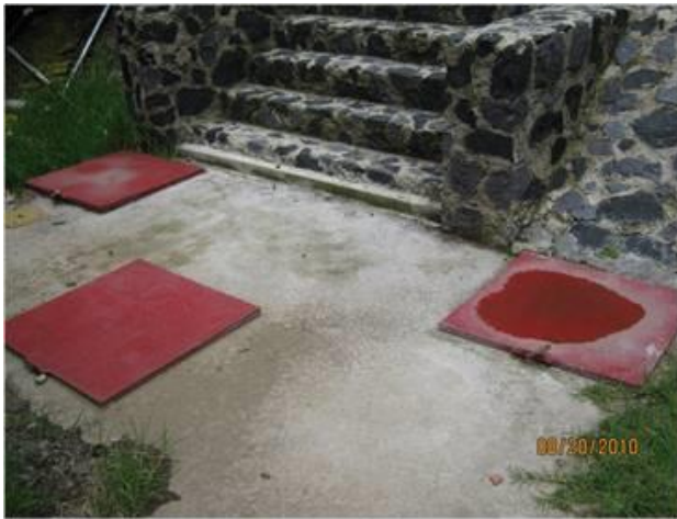
Foto A.2.5. Fosa séptica (FS-01) ubicada frente al humedal artificial
