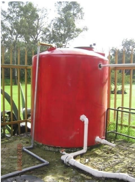
Foto A.2.7. Tanque cisterna de igualación, nivelación o dosificación (TC-101)
