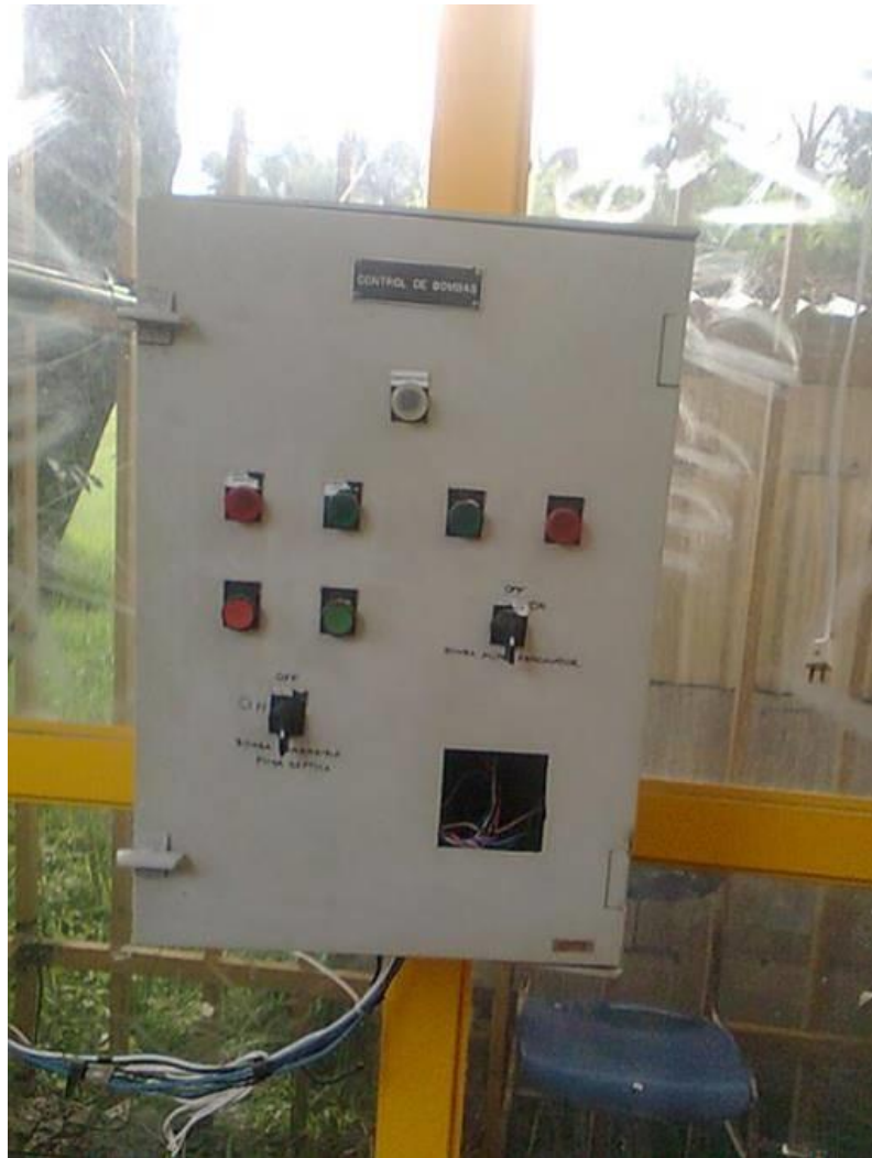
Foto A.2.9. Tablero de control de bombas (Arrancadores, relevadores, guardamotors, botoneras arranque o paro)
