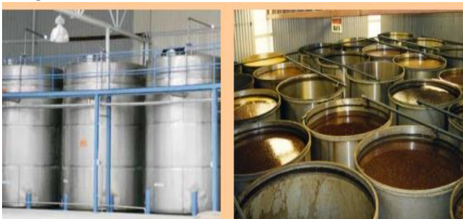
Imagen 8. Tinas de acero inoxidable en fábrica de mezcal del estado de Oaxaca.
