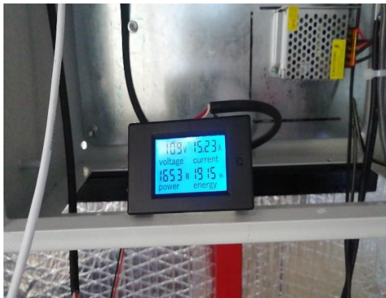
(i) Analizador de factores eléctricos
