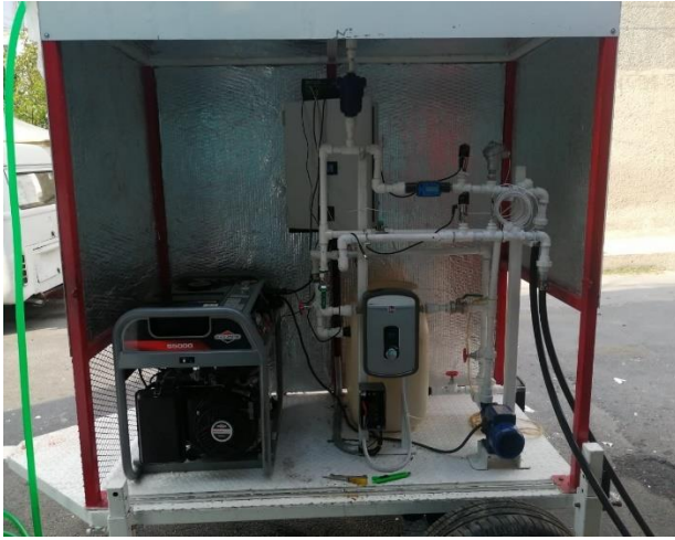
(m) Prueba de funcionamiento del equipo TRT-IIUNAM completo
