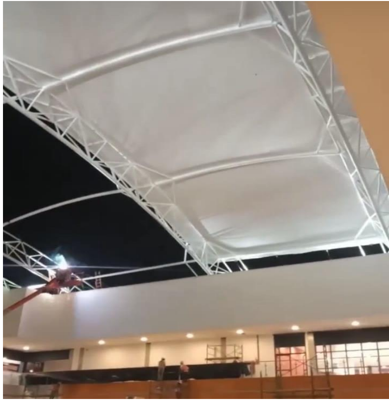
Colocado y soldado de riostras y largueros a los elementos prefabricados para dar mayor rigidez a la cubierta. Instalación de membrana blanca de la cubierta. | Foto brindada por (Pastor, 2020).
