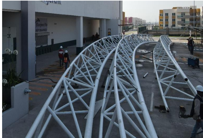
Descarga de elementos prefabricados para la cubierta ligera del centro comercial. | Foto brindada por (Pastor, 2020).
