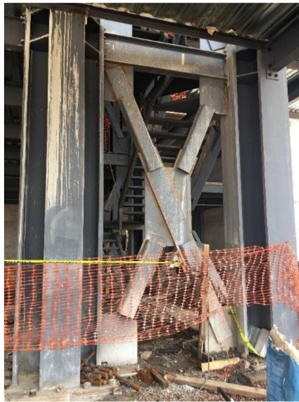
Figura 5.30. La placa del centro en donde se unen los elementos lineales es conocida como “placa de empalme”
