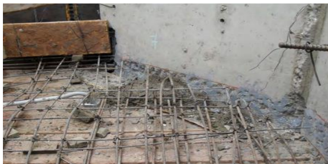
Fig. 2.22. Descanso de una escalera. La malla de acero no está anclada a la placa y no presenta uniformidad en cuanto la separación de las barras.
