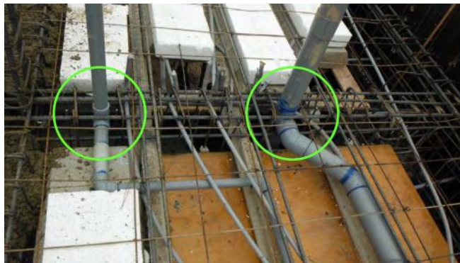
Fig.2.19 tuberías de agua atravesando una viga. Reduce la sección resistente en ciertos tramos de la viga.
