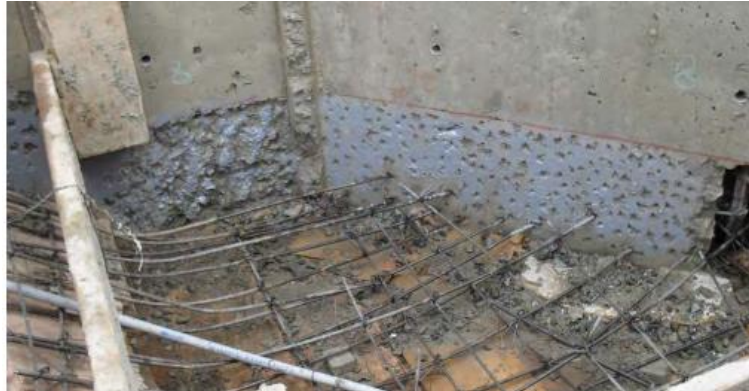
Fig. 2.23. Descanso de una escalera. Puede verse la deficiente escarificación de la placa en donde se pegará el descanso y la contaminación.
