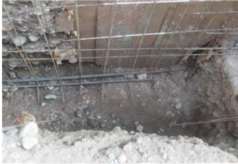
Fig. 1.14: Carencia de solado en la base del futuro cimiento.
