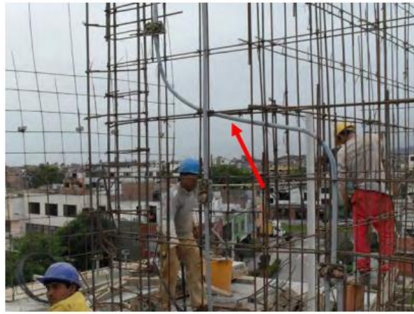
Fig. 2.6. Tubería de PVC que comunica dos cajas de electricidad a su vez está cortando horizontalmente a una placa.
