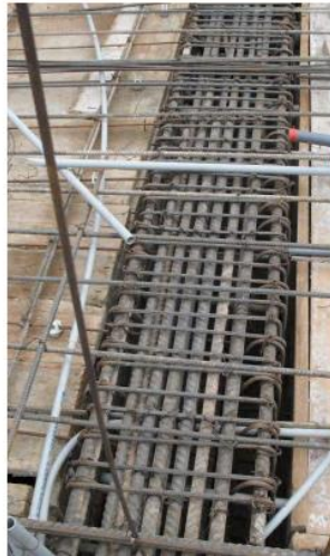
Fig.2.14. Armaduras de viga, con el acero longitudinal prácticamente pegado barra con barra, además de no presentar recubrimiento con respecto al encofrado lateral.
