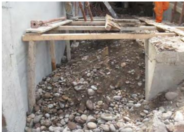
Fig. 1.17 Acumulación de relleno sin compactar, incluso con abundancia de piedras grandes.
