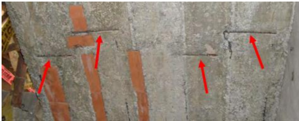
fig. 2.25 Fondo de escalera (vista desde bajo), nótese los fierros que han quedado expuestos debido a la ausencia de separadores de concreto durante el vaciado.
