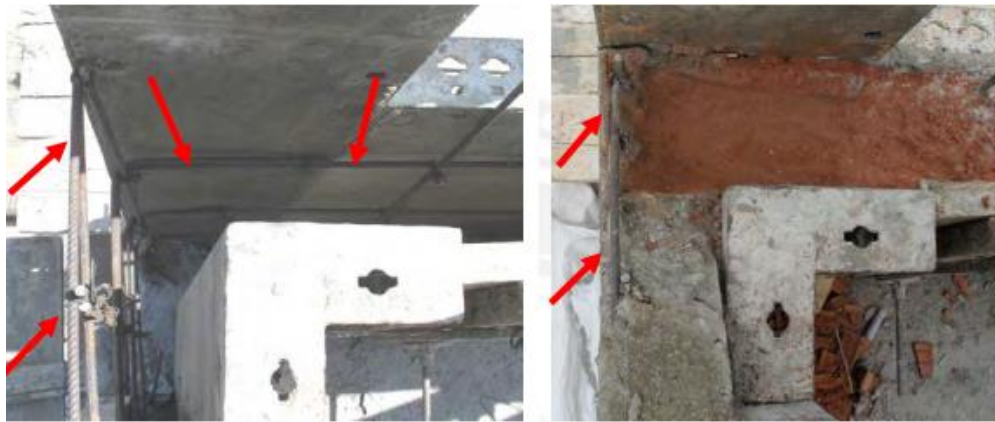
Fig. 2.7. Placa del concreto luego del vaciado nótese la falta de recubrimiento del acero.
