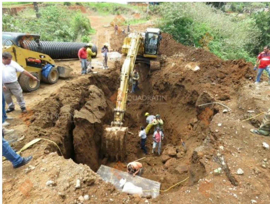
Fig. 5.1. Derrumbe de zanja de construcción de un colector.
