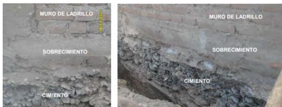
Figs. 1.11. (a, b): Concreto ciclópeo mal dosificado, las piedras de zanja ocupan la mayor parte del cemento corrido.
