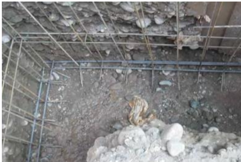
Fig. 1.15: Anclajes erróneamente apoyados en piedras de poca estabilidad. (PUCP; 2013: 22)
