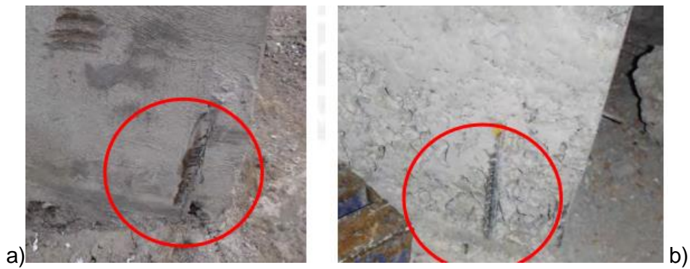
Figs. 2.11 (a, b) Resultado de anclar las barras de tope por dentro de la columna, al final estas quedan expuestas a la intemperie y en peligro de oxidación.
