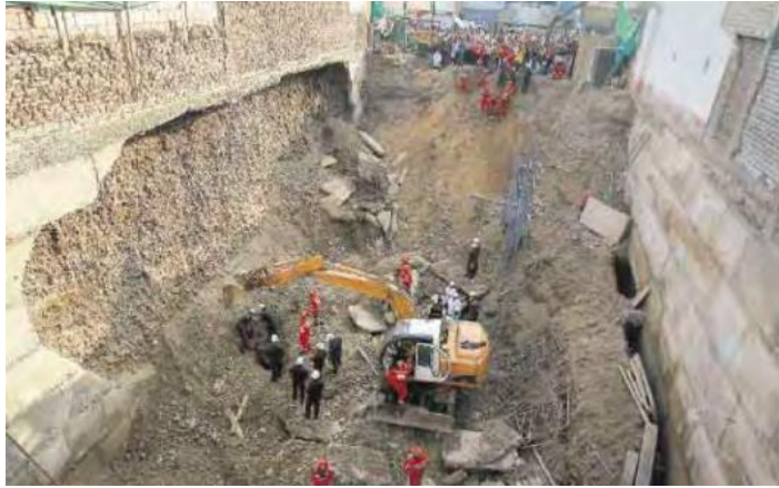
Fig. 1.21: Desplome de calzada mal construida. El empuje del suelo superó a la estabilidad de la estructura. Estructuras colapsadas.
