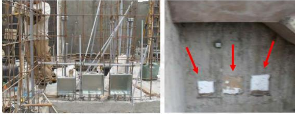
Fig. 2.5. Cajas de electricidad empotradas en la armadura antes y después del vaciado. (PUCP; 2013: 33)
