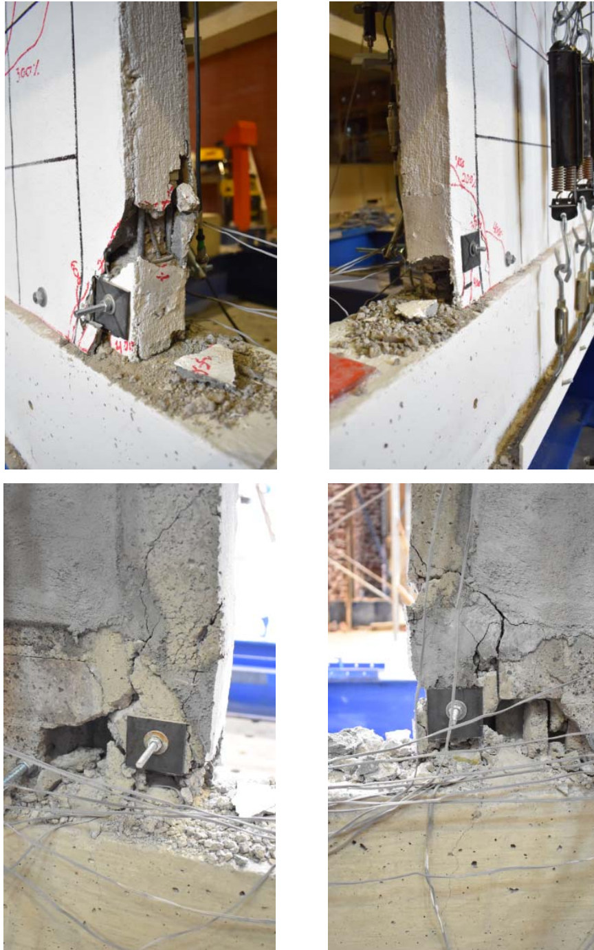
Figura 42. Daño en extremo inferior de los castillos
