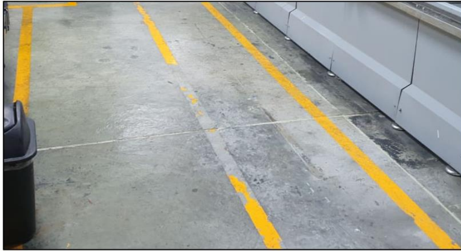
Figura 4.17 Las líneas amarillas de seguridad en el suelo deben ser repintadas. Fuente: fotografía tomada en la empresa donde se realizó el estudio.
