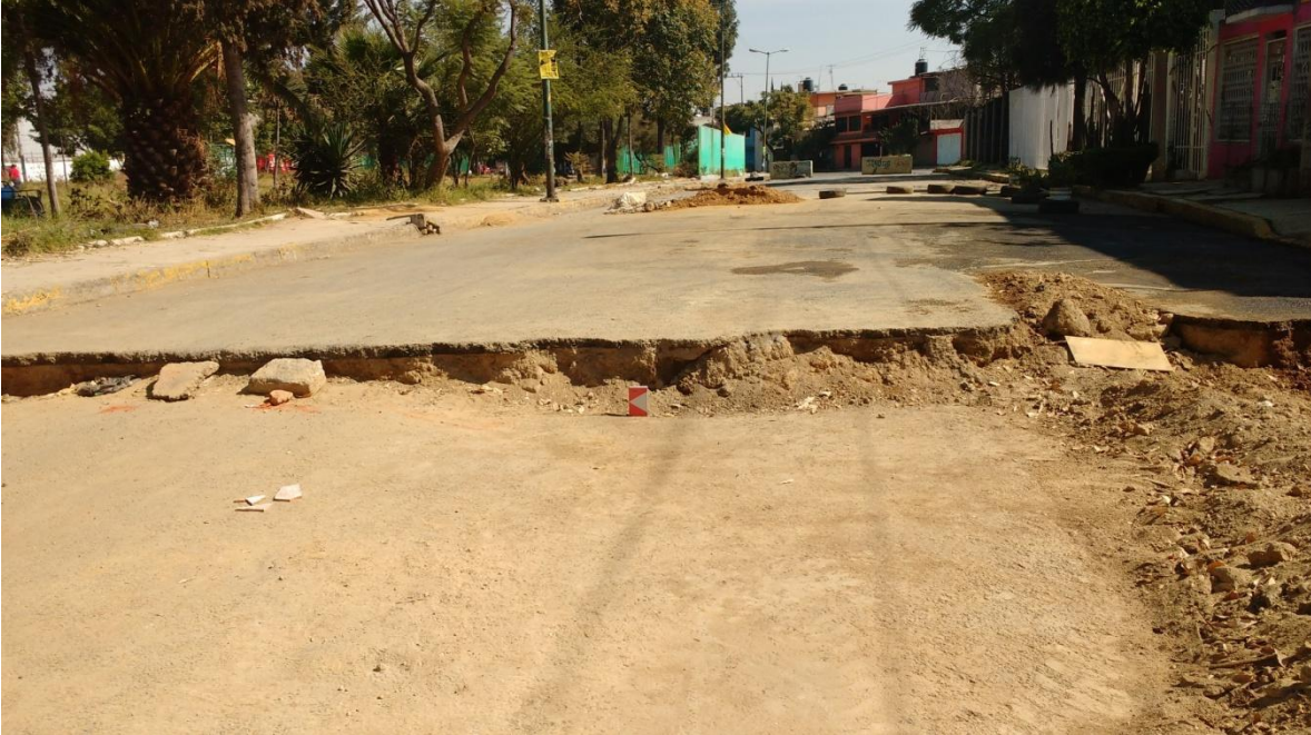
Figura 2.23. Fracturamiento con un escalonamiento vertical a causa del sismo en calle Pintapan, U.H. Cananea.
