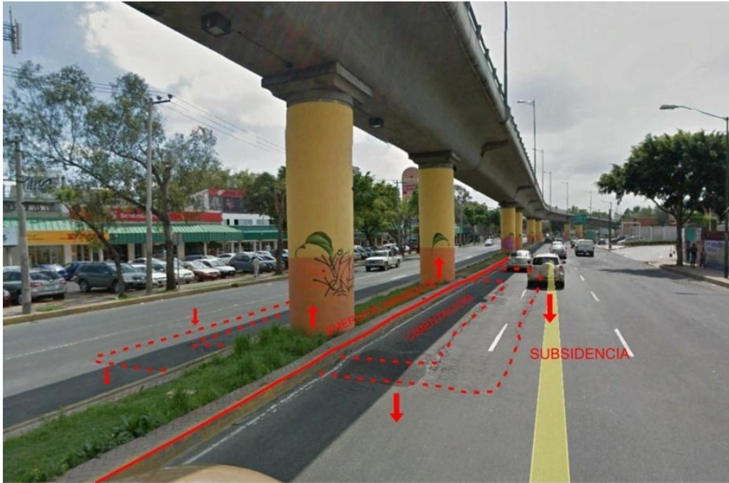
Figura 2.12. Emersión aparente de cajones de cimentación del puente vehicular de la calzada Ermita Iztapalapa sobre la avenida Eje 3 Oriente.
