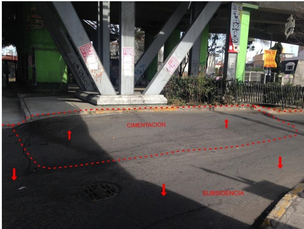
Figura 2.13. Emersión aparente de cajones de cimentación del puente vehicular del Eje 6 Sur Trabajadores Sociales sobre la avenida Eje 3 Oriente.
