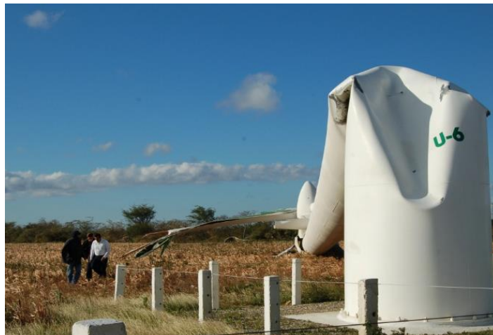
Figura 29. Otra vista del aerogenerador de la marca Vestas derribado por los fuertes vientos en La Venta. Fuente: Asamblea de Pueblos Indígenas de Istmo Oaxaqueño [31]
