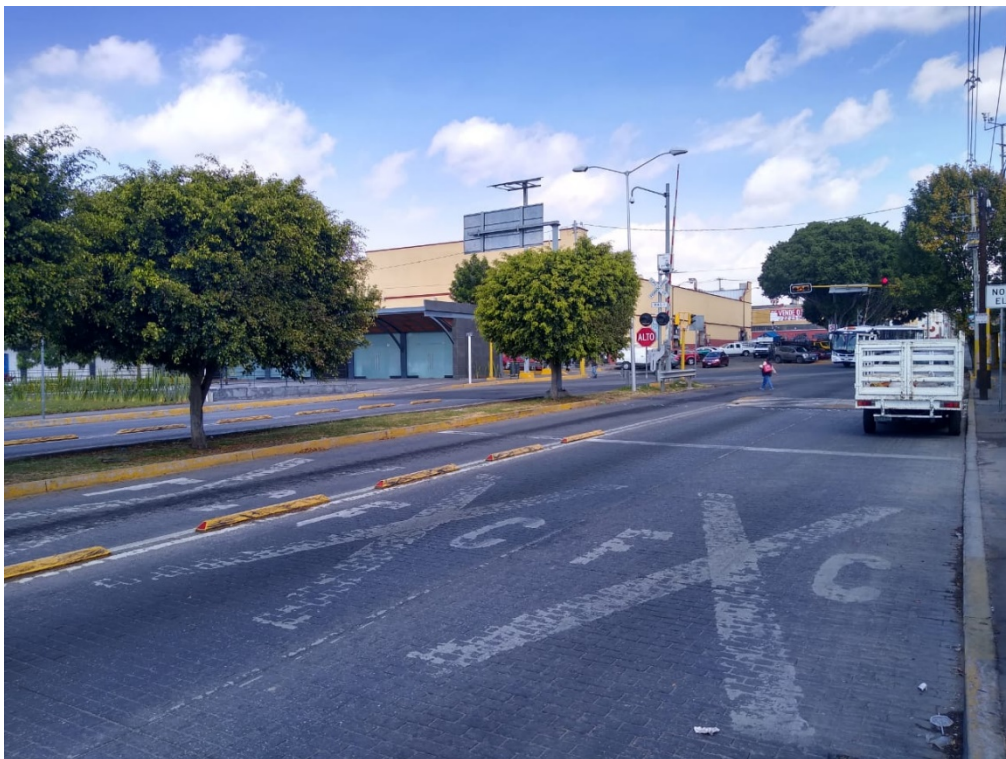
Fotografía 2. Desgaste en el señalamiento horizontal.
