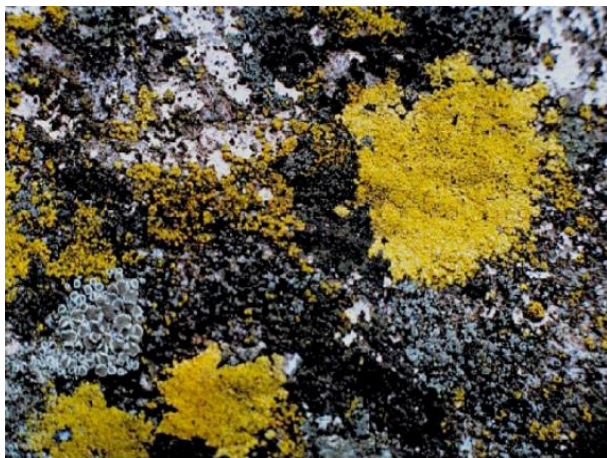
Figura 5. Concreto biológico en fachadas, generación de musgos.
