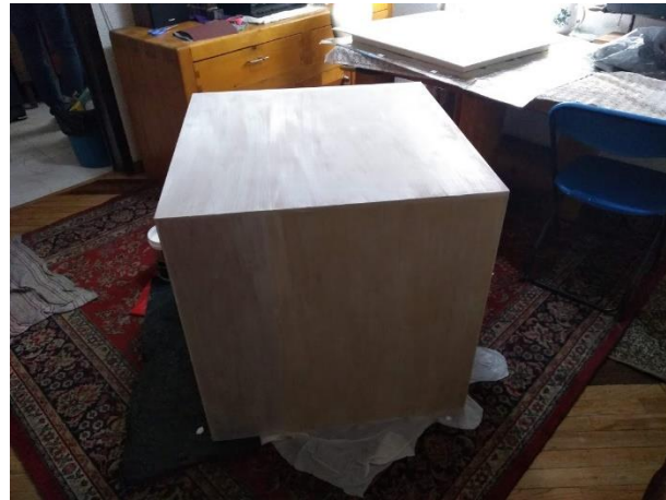
Imagen 46. Construcción del módulo de prueba. Aplicación de impermeabilizante color blanco en el exterior.
