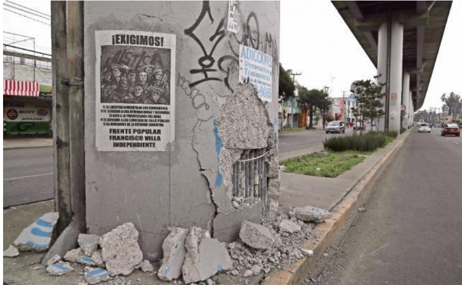
Figura 2.4. Falla en columna de puente durante sismo de Axochiapan 2017 (2017, www.eluniversal.com.mx )
