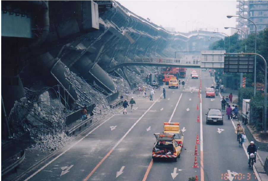
Figura 2.1. Colapso del puente Hanshin durante el sismo de Kobe en 1995 (Kawashima, 2000)
