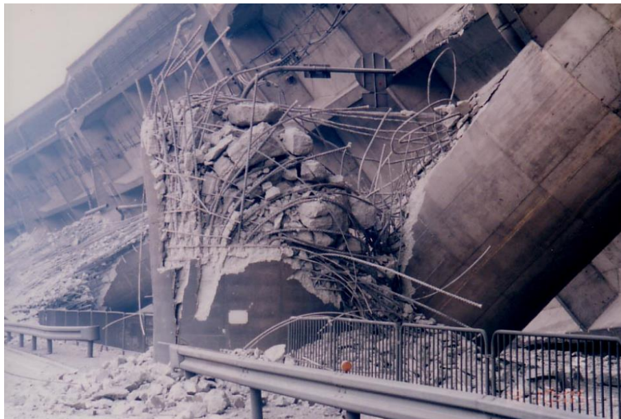
Figura 2.5. Falla flexo-cortante debido al corte prematuro del refuerzo longitudinal (Kawashima, 2000)
