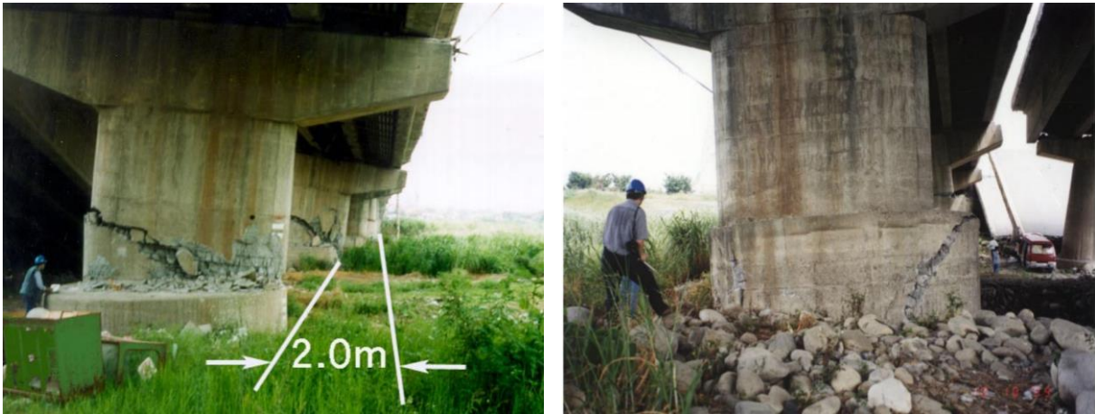
Figura 2.8. Falla por cortante en las columnas del puente Wu-Shi, durante el sismo de Chi Chi, Taiwán, en 1999 (Kawashima et al. , 2000)
