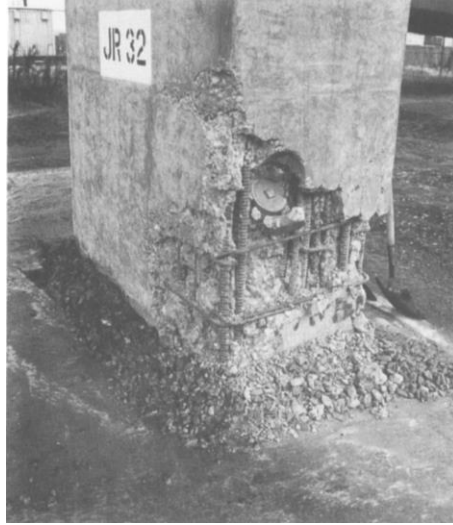
Figura 2.2. Falla por adherencia en la base de la columna (Priestley et al. , 1996)
