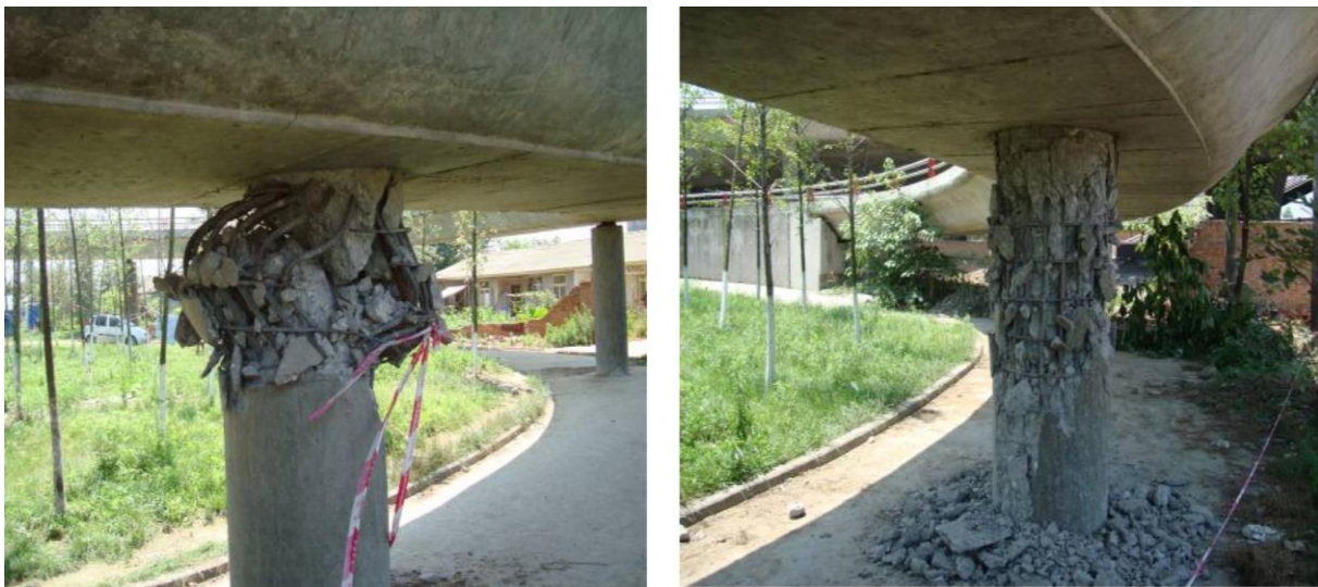
Figura 2.9. Fallas por cortante, sismo Wenchuan en 2008 (Kawashima et al. , 2009)
