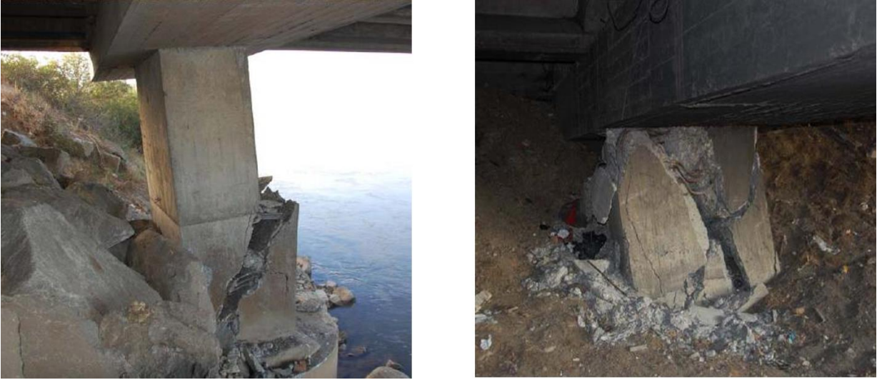
Figura 2.10. Fallas por cortante, sismo de Chile en 2010 (Barriga, 2011)
