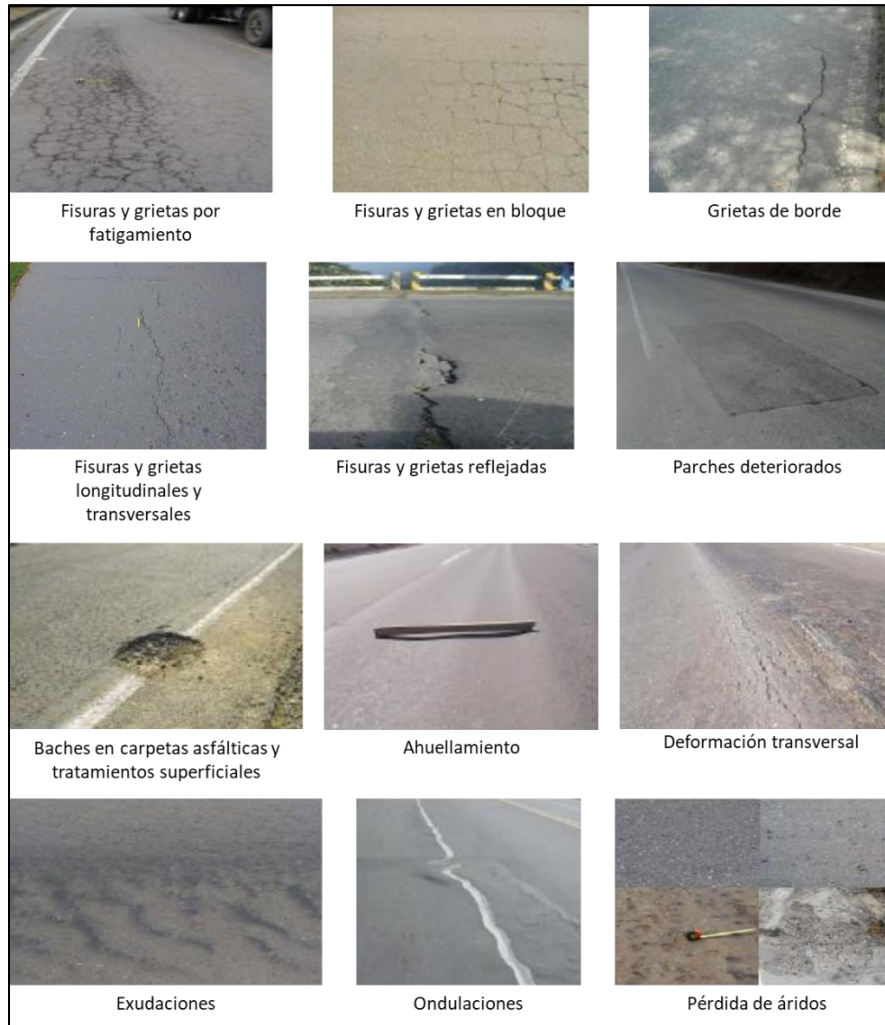
Figura 4. Fisuras, grietas y deterioro superficial común en carpetas asfálticas. Fuente: (Miranda-Rebolledo, 2010).
