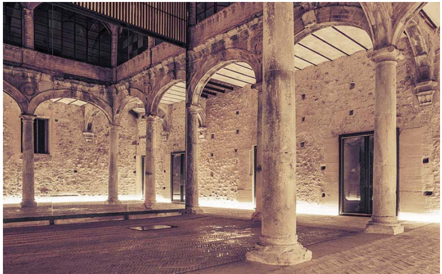
Villalba, M. (2014). Palau-Castell. Betxi /// Recuperación claustro [Fotografía]. El fabricante de esferas. http://web.elfabricantedeesferas.com/palaucastellbetxi/
