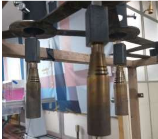
Figura A.10 Uniones de acero en los quemadores.
