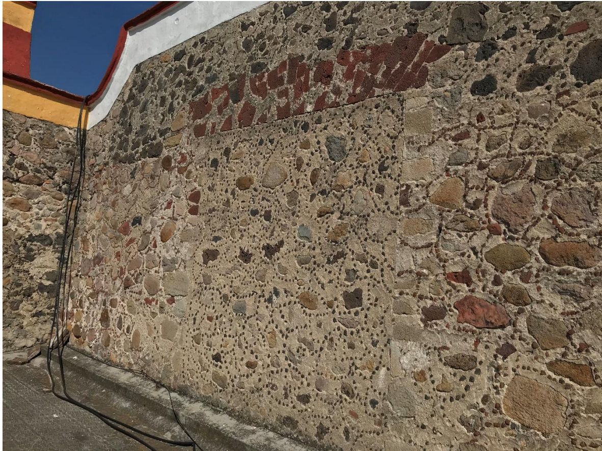
Imagen 16.- Ventana tapiada, muro sur. Parroquia de San Bartolomé Apóstol, Oztolotepec, Estado de México. Imagen: ARA, 2020.
