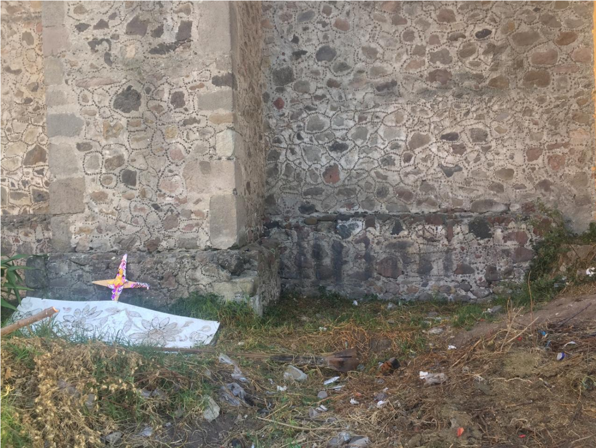
Imagen 15.- Cimientos y mampostería del muro norte. Parroquia de San Bartolomé Apóstol, Otzolotepec, Estado de México. Imagen: ARA, 2020.
