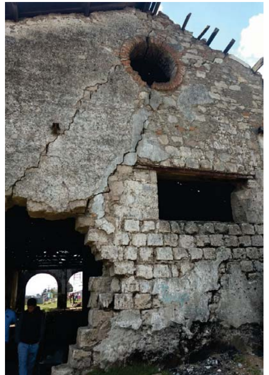
8. Desprendimiento de material en muro y manchas por quema de basura.
