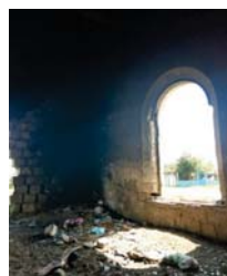
7. Falta de cancelería.
