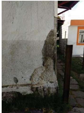
2. Desprendimiento de aplanado en muro.
