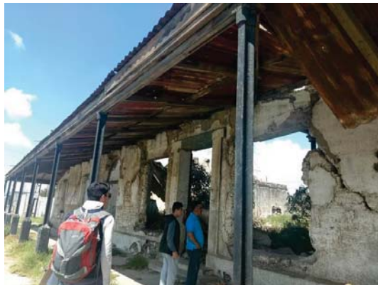
7. Grietas en muros falta de cancelería en fachada principal.
