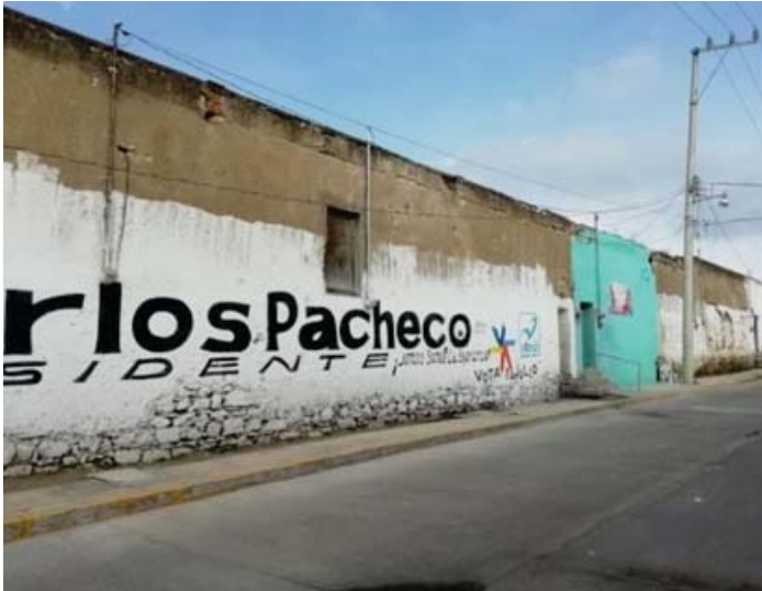
Figura 38. Se observan algunas de las viviendas construidas en 1876, mismas que son parte del conjunto ferroviario. Colocaron posteriormente un acceso a cada vivienda, dando hacia el exterior del conjunto. Las fachadas se observan deterioradas y vandalizadas. Fuente: Elaboración de la autora.
