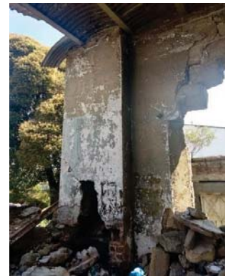
5. Grieta en muros.
