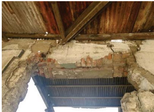
4. Grietas en muros, falta cancelería en vanos.
