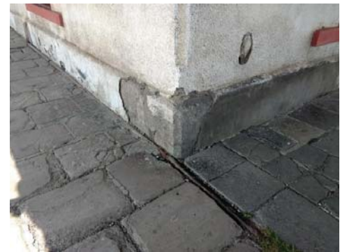
3. Desprendimiento de aplanado en muro.
