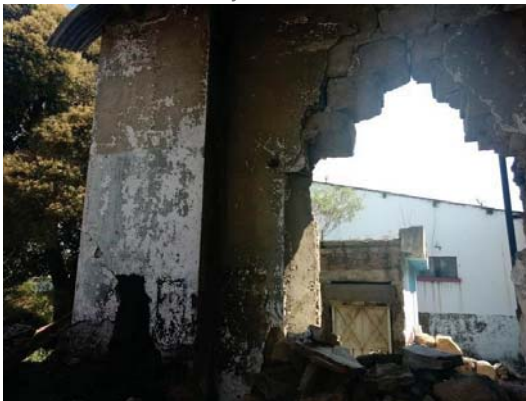
6. Desprendimiento de material en muros.
