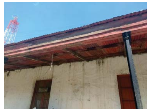
4. Esgurrimento en fachada principal.
