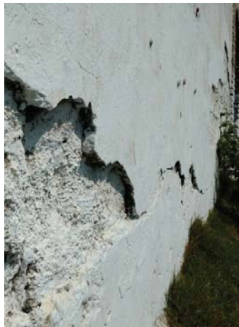
3. Desprendimiento de acabados.
