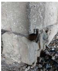
5. Desprendimiento de material en columna
