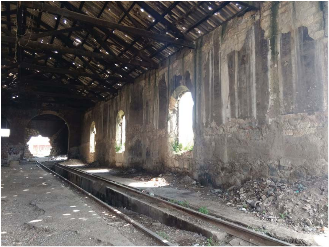
Figura 73. Interior de Casa de máquinas. Elaboración de la autora.
