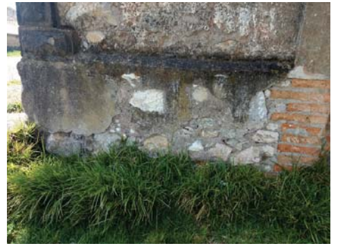
3. Desprendimiento de acabados y fauna nociva.
