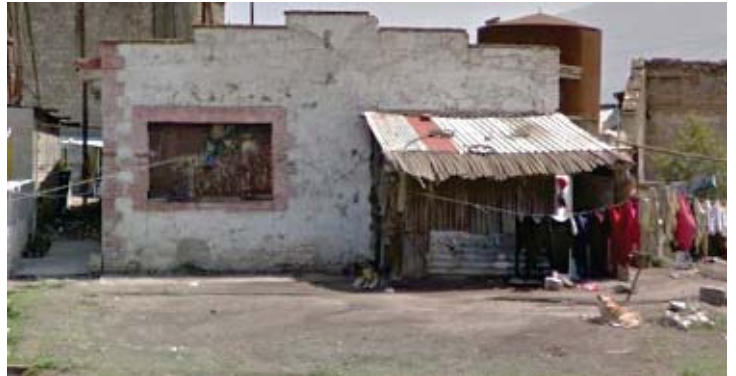
1. Desprendimiento de acabado y suciedad en muros.
