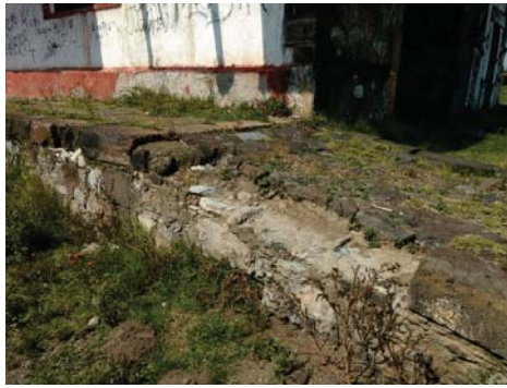
2. Desprendimiento de material en rampas.
