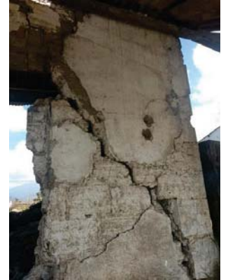
2. Grieta en muros.
