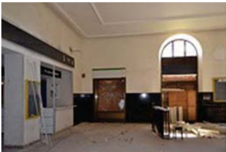
Deterioro en mobiliario
