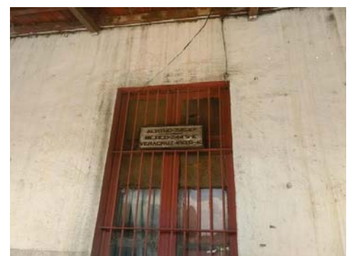
5. Esgurrimento en muros.
