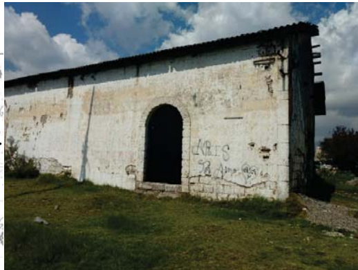
1. Desprendimiento de acabado y graffitis.
