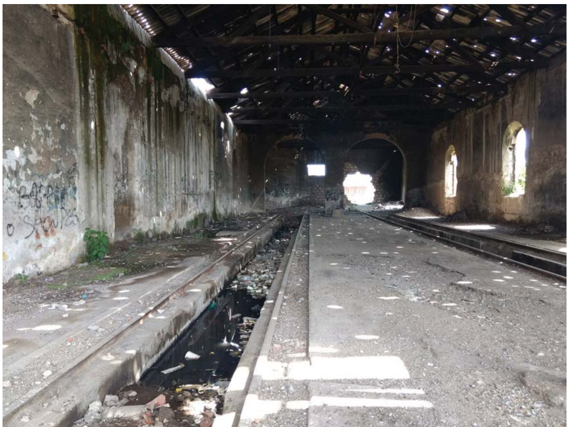
Figura 71. Interior de Casa de máquinas. Fuente: Elaboración de la autora.
