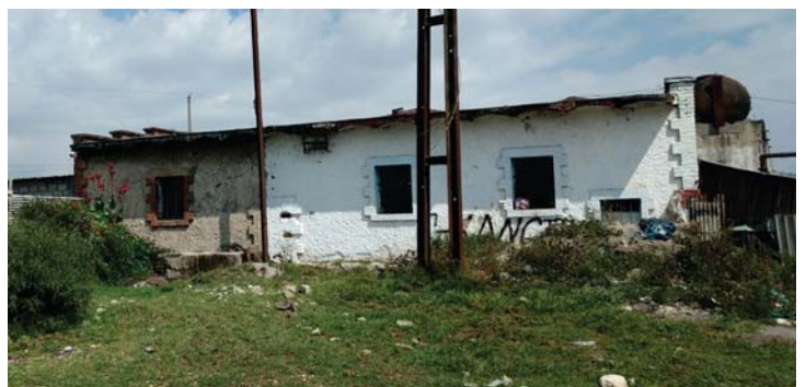
3. Techo deteriorado, y manchas por suciedad en muros.
