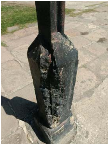
1. Desgaste de material en dado de concreto.
