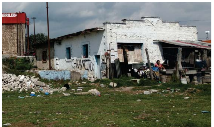
2. Graffiti en muro lateral y presencia de grietas.
