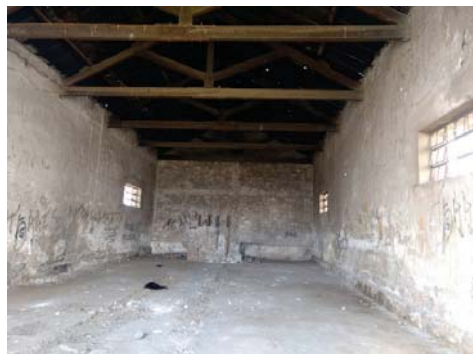
4. Fauna nociva, presencia de graffitis y desprendimiento de acabados.
