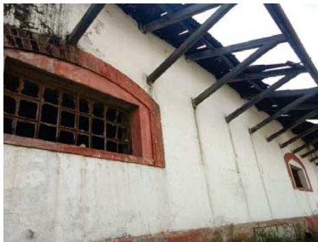
5. Falta de de material en cubierta.
