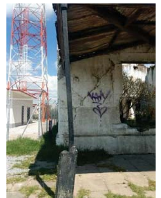
8. Desplome de columna de acero.
