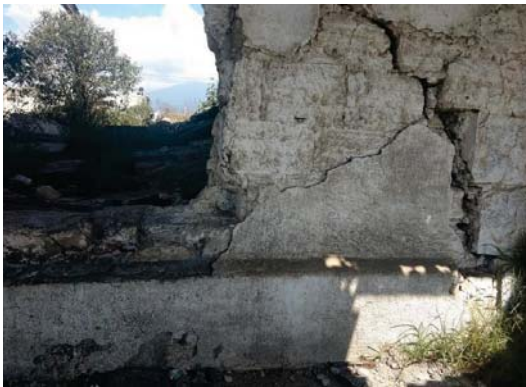
3. Grietas en muros y flora nociva.
