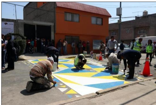
Imagen 32. Señalización de grietas con pintura en delegación Iztapalapa, se marcaron para ubicarlas y darles mantenimiento. Grietas resultado de los sismos que se presentan en la CDMX y que en 19 de septiembre 2017 se evidenciaron y aparecieron nuevas. Foto @Alfredo Moreno. Fuente: https://www.elnorte.com/aplicacioneslibre/preacceso/articulo/default.aspx?rval=1&urlredirect=https://www.elnorte.com/ubica-iztapalapa-grietas-con-pintura/ar1667329?referer=-
