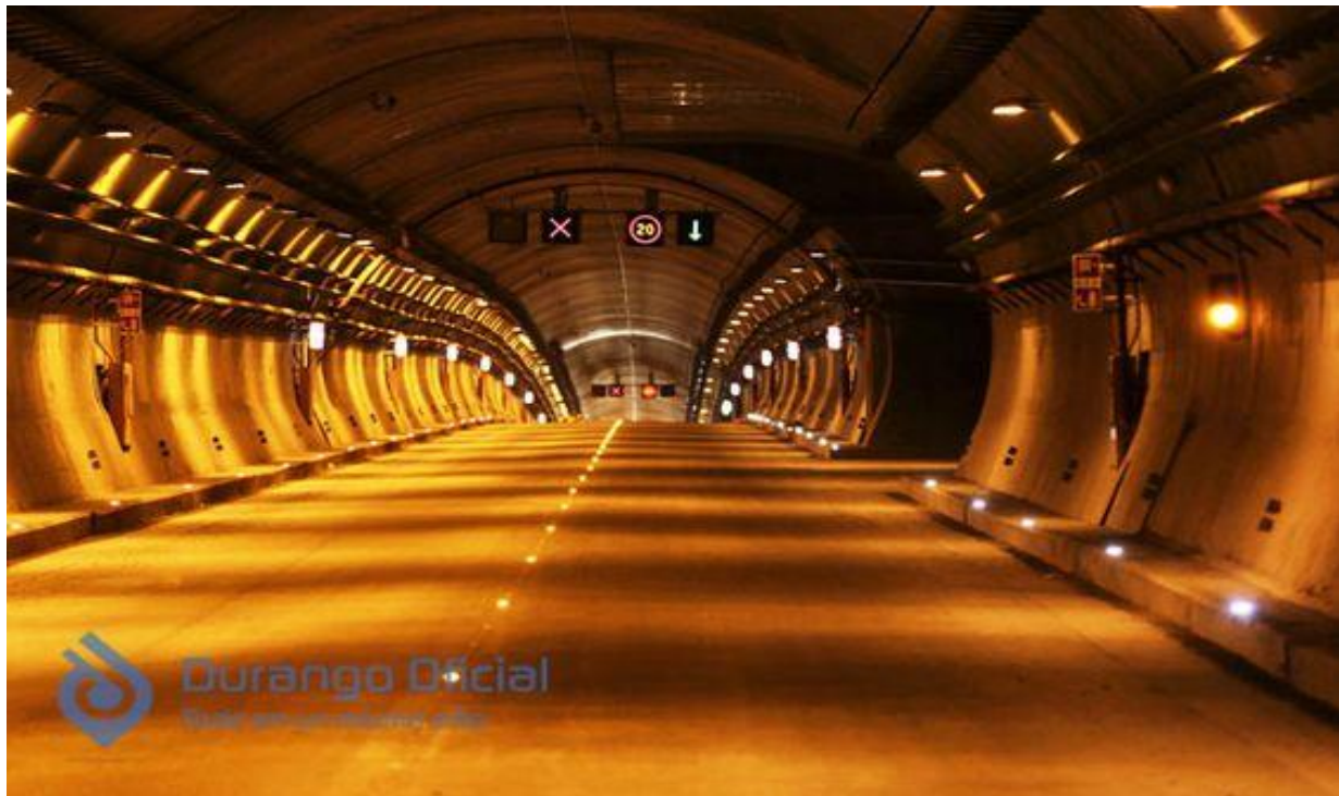
Figura 8 Sistemas Inteligentes de Transporte en el Túnel "El Sinaloense" (Parra, 2019).
