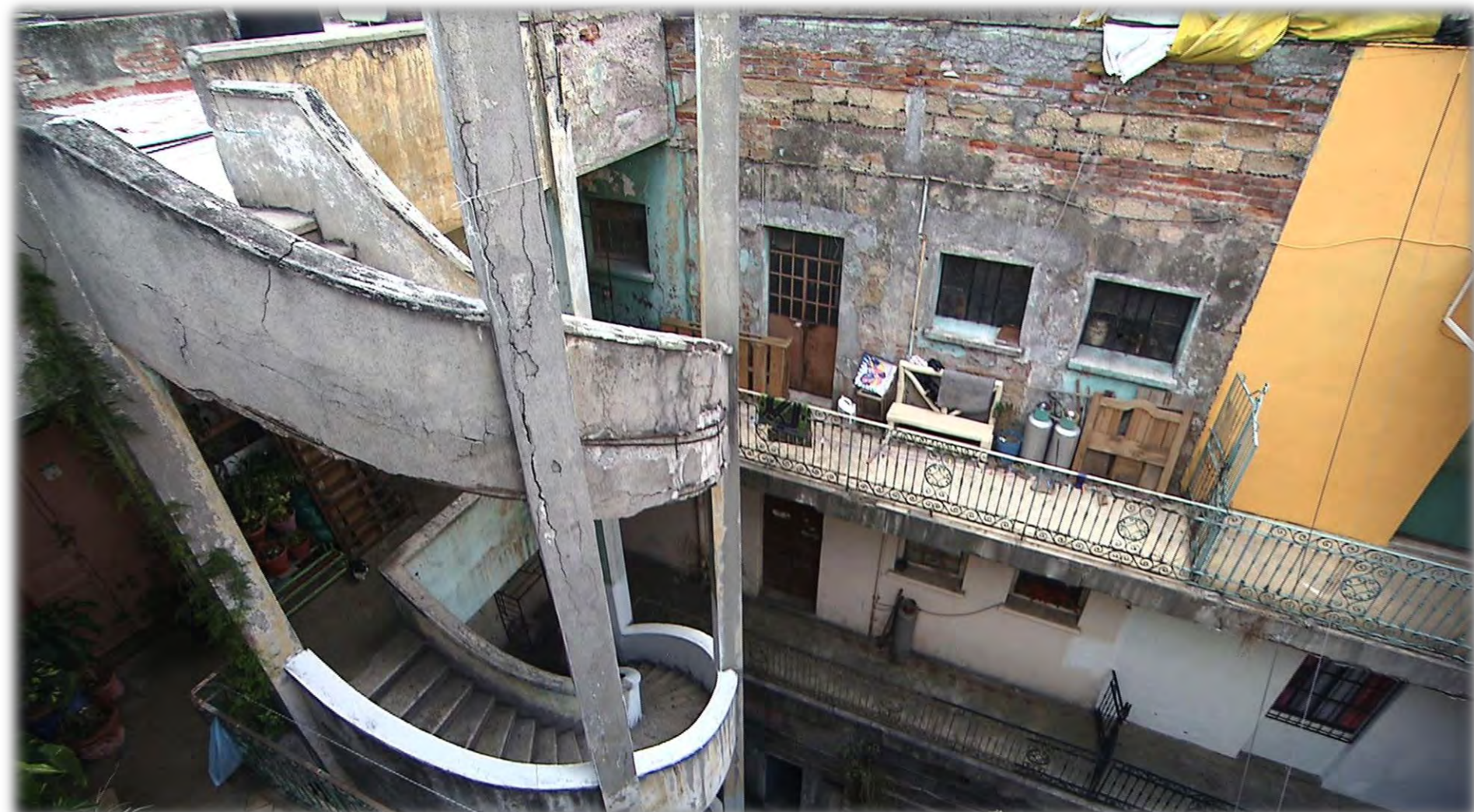
Imagen 1.30. Vivienda abandonada. Fuente: Tenorio Álvarez Luis Fernando, vecindad en la Colonia Morelos, CDMX, 2019.
