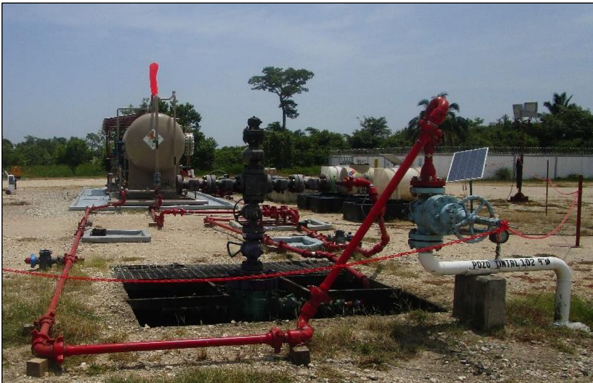
Figura 1.18 Compresor a boca de pozo (Gas jack)
