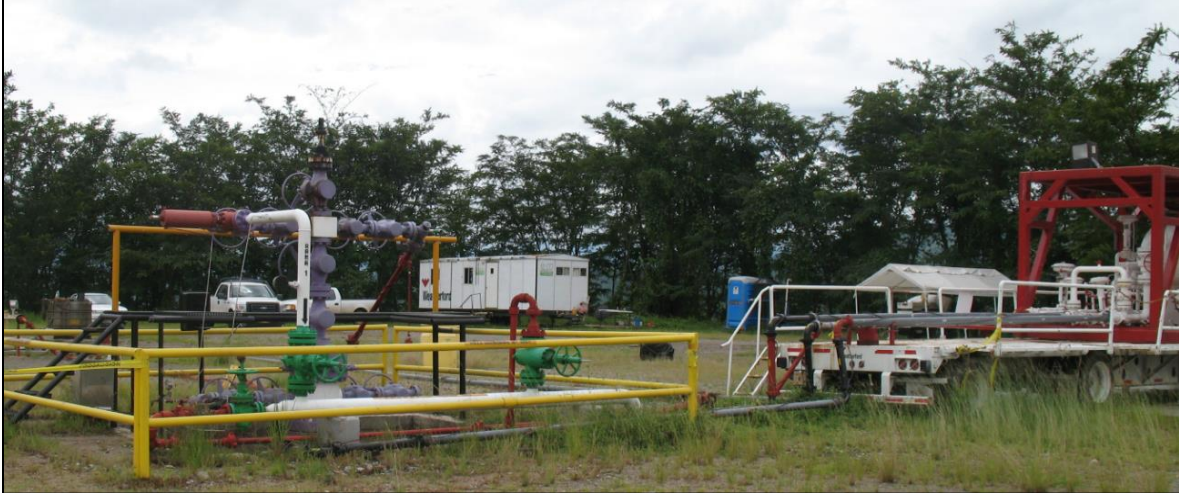
Figura 1.12 Instalación superficial del Bombeo hidráulico
