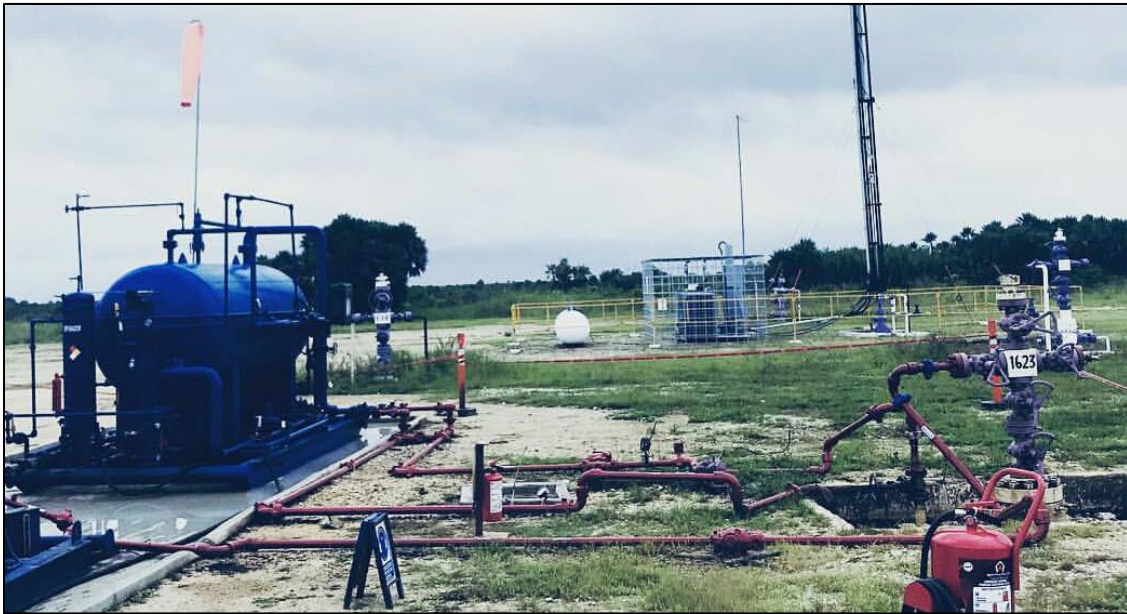
Figura 1.15 Instalación superficial del Bombeo Neumático
