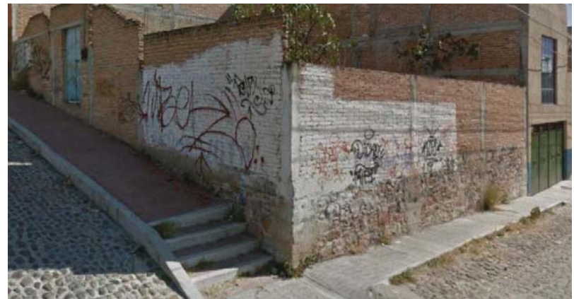
Imagen 14. Inmuebles en mal estado producto de la segregación social.
