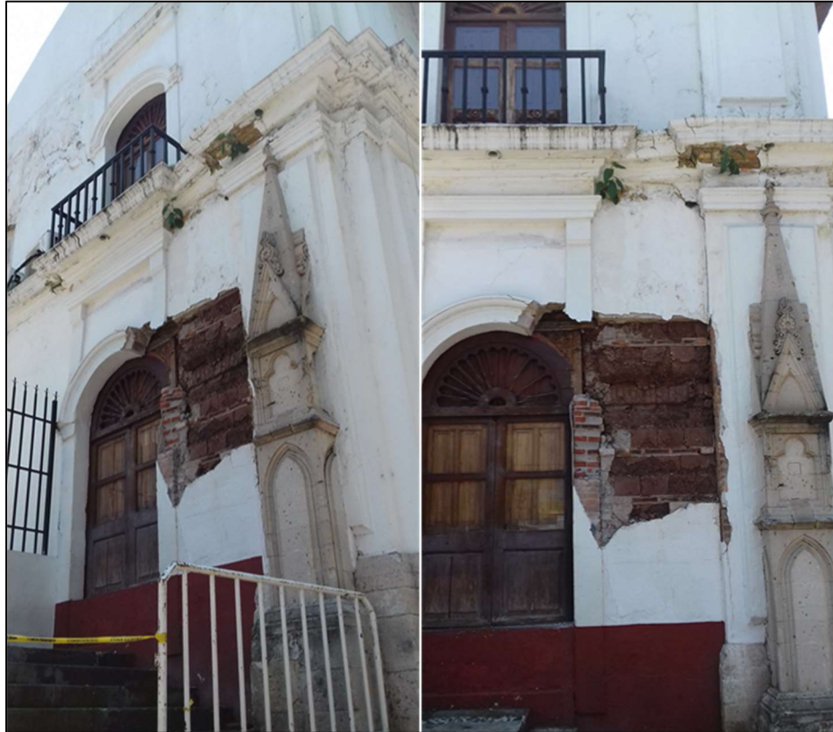
Imágenes 3.1. Daño actual en un muro del edificio de la Casa de la Cultura en Uruapan, Michoacán, desde dos perspectivas. (Fuente: Propia; 2019)
