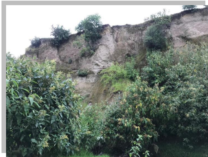
Figura 32. Punto de verificación D ; deslizamiento de escombros. Se observa material deslizado como raíces de árboles y arbustos.
