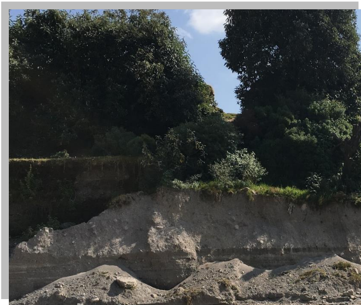
Figura 30. Punto de verificación B ; deslizamiento de escombros. Con presencia de depósitos.
