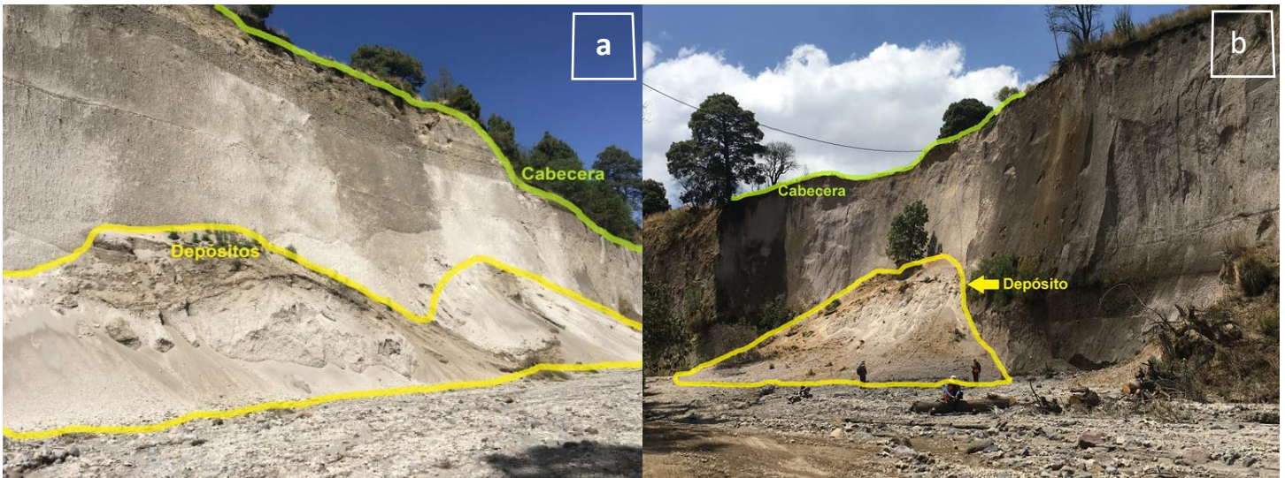
Figura 2. Deslizamientos de escombros. a) Localizado a 3,130 m.s.n.m, en el margen derecho del cauce principal. El deslizamiento tiene 30 m de altura, 206 m de longitud y 2 m de profundidad; b) Localizado a 3,105 m.s.n.m, en el margen izquierdo del cauce principal. El deslizamiento tiene 40 m de altura, 330 m de longitud y 3 m de profundidad.
