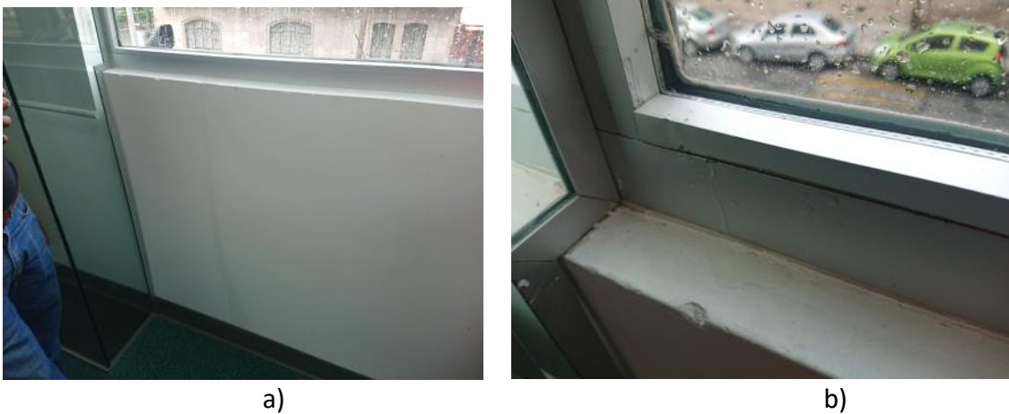
Figura 28. Prueba Tipo 2, a) introducción de agua y posteriormente se genera un escurrimiento hacia los antepechos interiores; b) infiltraciones de agua a través de los perfiles de aluminio.
