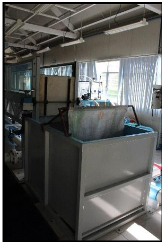
Figura 4.2 Tanque de llegada.
