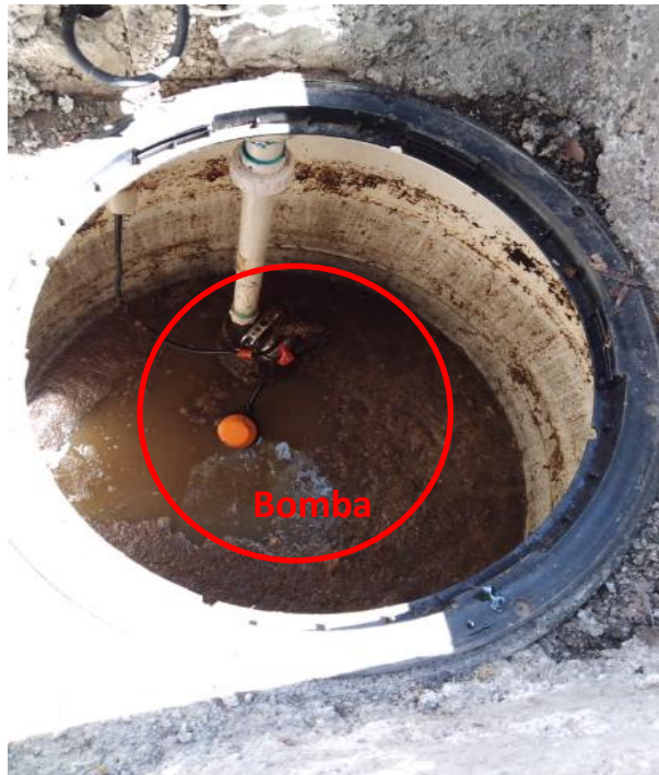
Figura 3. 5 Bomba RXm 2/20 VORTEX instalada en cárcamo (Fecha: 14 de marzo 2019)
