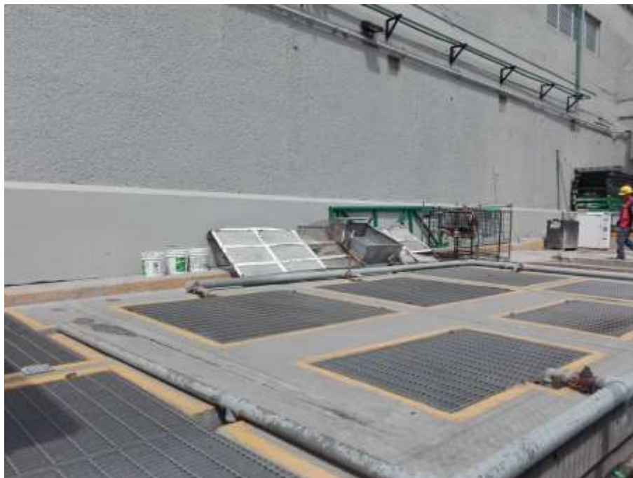
Fotografía 17.- Secciones de cribado.
