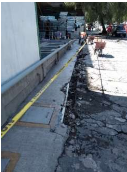
Fotografía 14.- Instalación de llegada a la Planta de Tratamiento.
