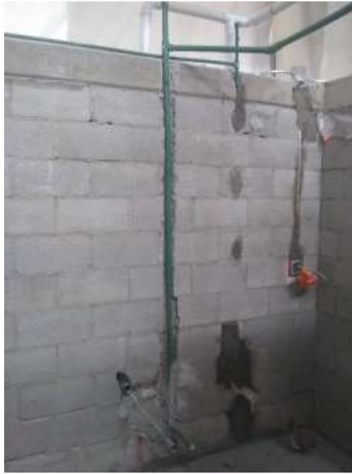
Fotografía 12.- Instalación hidrosanitaria del retrete.
