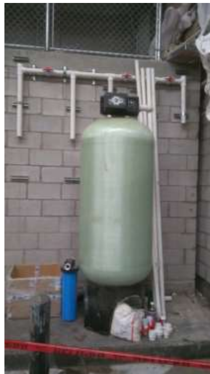
Fotografía 19.- Tanque de filtrado.
