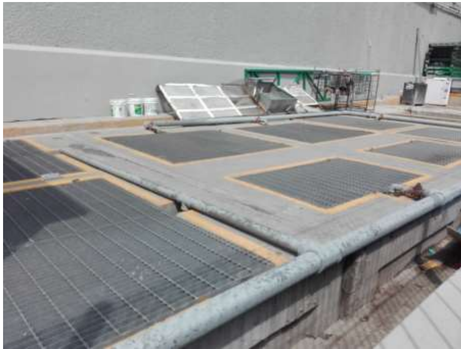
Fotografía 16.- Protección de planta de tratamiento.
