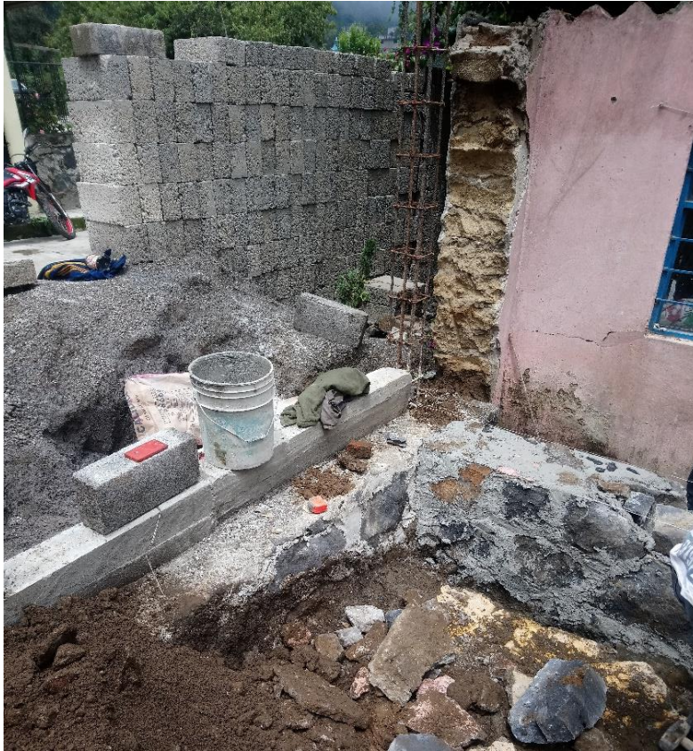
Figura 17. Vivienda de concreto y adobe en Ecatzingo afectada por el sismo. (agosto, 2019)
